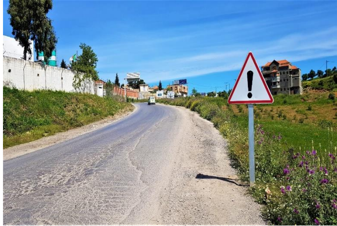
Figure III.21 Les fissures paraboliques de glissement.
