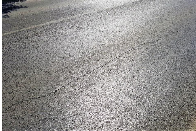
Figure III.22 Les fissures longitudinales.
