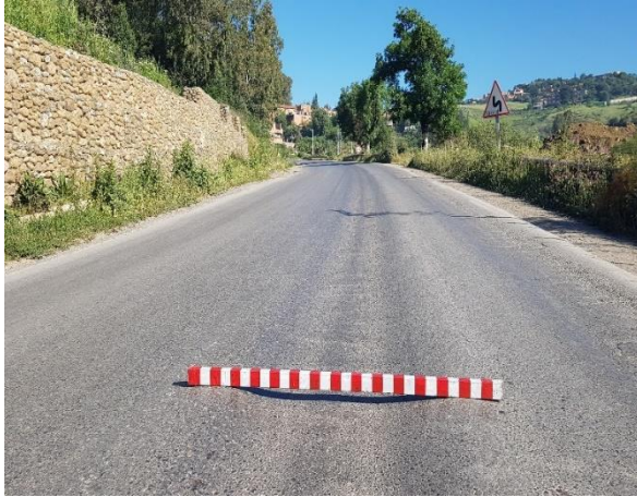
Figure III.17 Les ornières à petit rayon.
