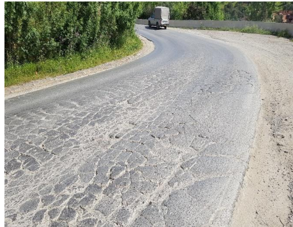
Figure III.20 Les faïençages à mailles fines.
