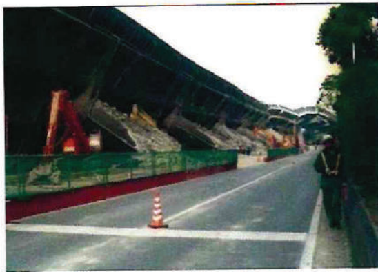
Fig.2.15 Rupture de toutes les piles par cisaillement (1995 Hyogoken-Nanbu, Japon)
