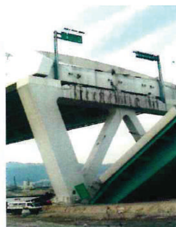
Fig.2.8 Effondrement du tablier à cause d'une liquéfaction du sol, phénomène inconnu à cette époque (1995 Hyogoken-Nanbu, Japon)
