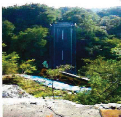
Fig.2.4 Perte d'assise et chute du tablier du au déplacement relatif des appuis (2008 Sichuan (Wenchuan), Chine)
