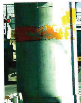
Fig.2.18 Voilement d'une pile métallique ronde (1995 Séisme de Kobé)
