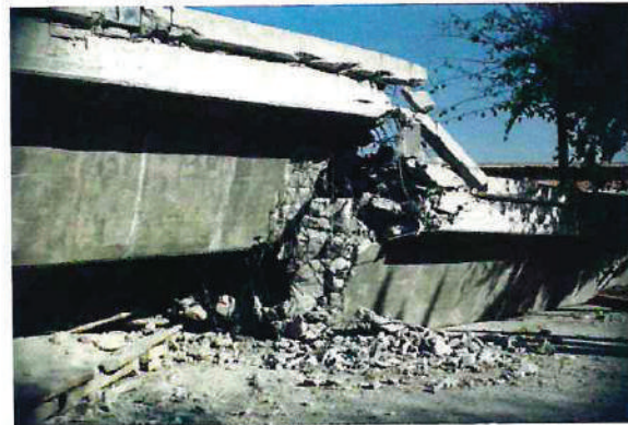
Fig.2.12 Effondrement des appuis par manque de résistance -Janvier, 1994 Northridge séisme, Californie
