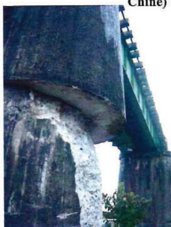
Fig.2.3 Déplacement entre les parties constituant les appuis dû à la force verticale importante du séisme (2008 Iwate-Miyagi, Japon)
