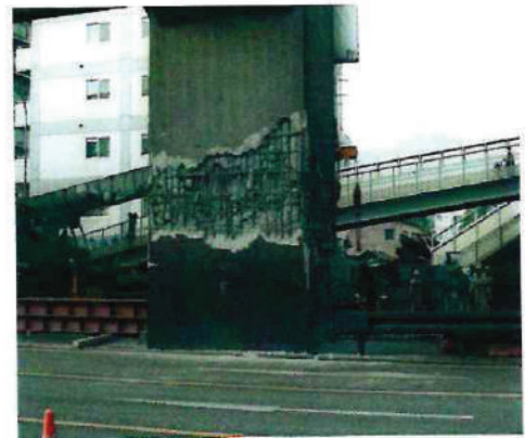
Fig.2.16 Flambement des armatures et éclatement de béton de la pile (1995 Hyogoken-Nanbu, Japon)
