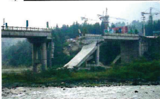
Fig.2.1 Perte d'assise du tablier dû au déplacement de la pile (2008 Sichuan, Chine)
