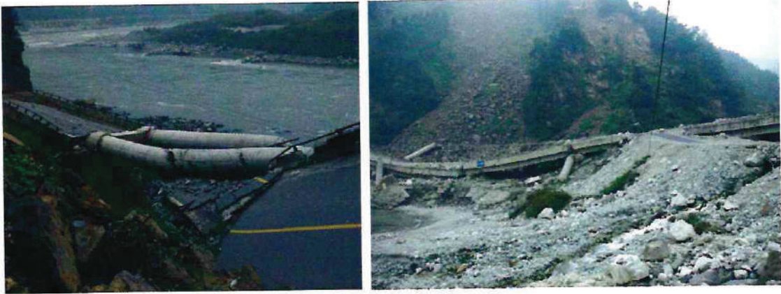
Fig.2.14 Effondrement des appuis par dépassement de capacité (2008 Sichuan Wenchuan, Chine)
