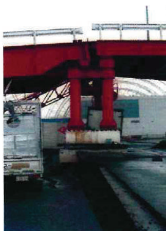
Fig.2.7 Soulèvement d'appui dû au mouvement du sol (Northridge, CA, 17 janvier 1994 Japon)
