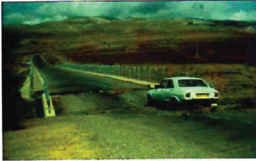
Fig.2.9 Rupture de la dalle de transition (1980 El Asnam, Algérie)
