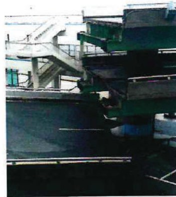
Fig.2.13 Effondrement des appuis par manque de résistance 1995 séisme de Hyogoken-Nanbu, Japon
