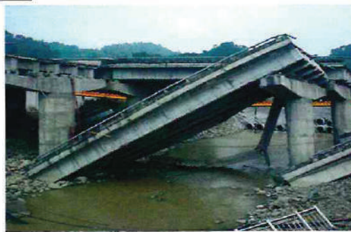
Fig.2.2 Perte d'assise du tablier à cause du déplacement de la pile (2008 Sichuan (Wenchuan), Chine)
