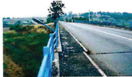
Fig.2.10 Déplacement relatif transversal de travées isostatiques (1980 Pont Isser-Boumerdes, Algérie)
