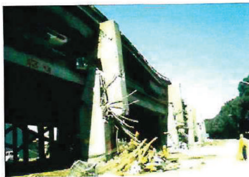
Fig.2.17 Glissement par cisaillement des piles supérieures du viaduc Cypress (1989 Séisme de LOMA Prieta-san francisco)
