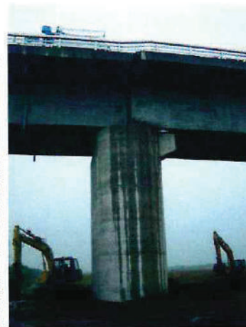
Fig.2.5 Déplacement relatif transversal des travées isostatique (2003 Tokachi-oki, Hokkaido, Japon)
