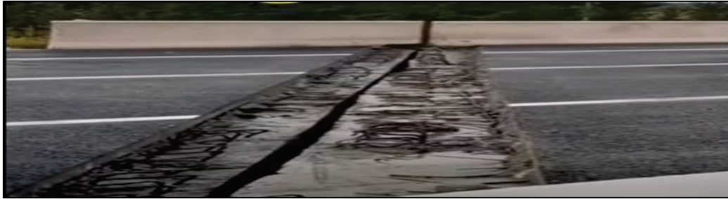
Figure XI-4 Désordre des joints.
