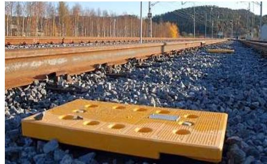
Figure VIII- 2: Une balise installée sur la voie
