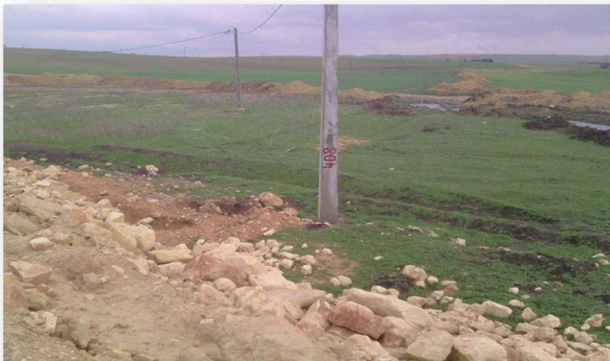
Figure.I.5. Les lignes électriques.
