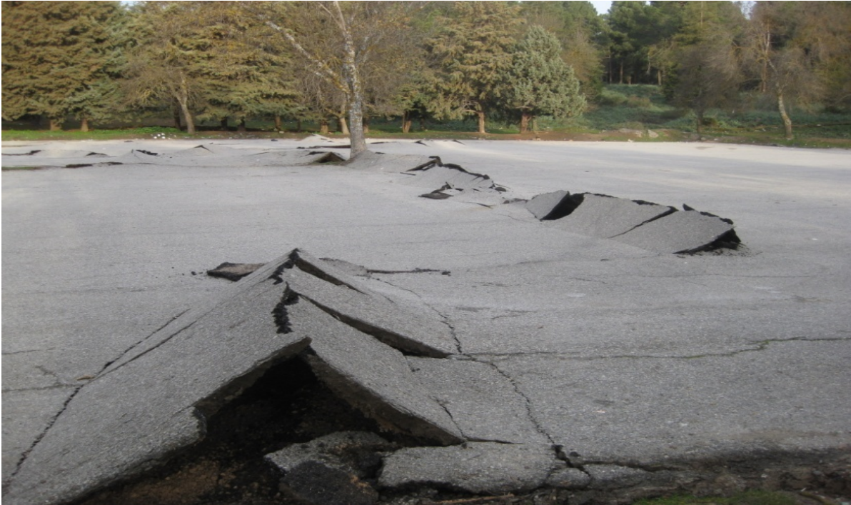
Figure II. 14: Soulèvement de la surface en haut de tunnel.
