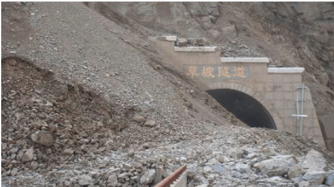
Figure I. 6: Glissement du terrain au voisinage du portail du tunnel.
