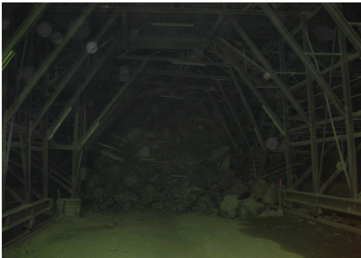
Figure II. 13: Éboulement du front de tube gauche.
