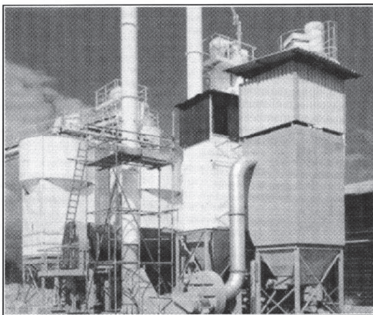
Dépoussiérage avec filtre à manches d'une installation de préparation de sable.
