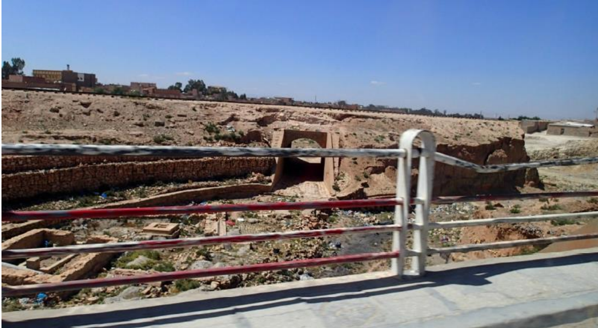
Figure VI. 3 : Action destructive de flux d'inondation sur le remblai de l'ancienne ligne ferroviaire.
