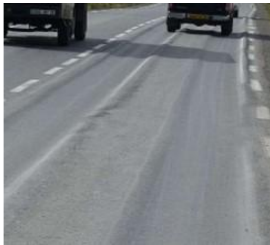
Figure I-4 : orniérage de la chaussée.
