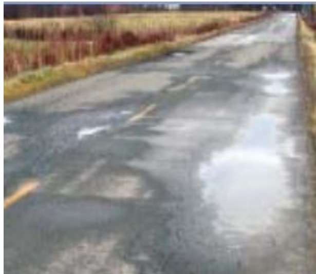
Figure I-5 : Affaissement de la chaussée.
