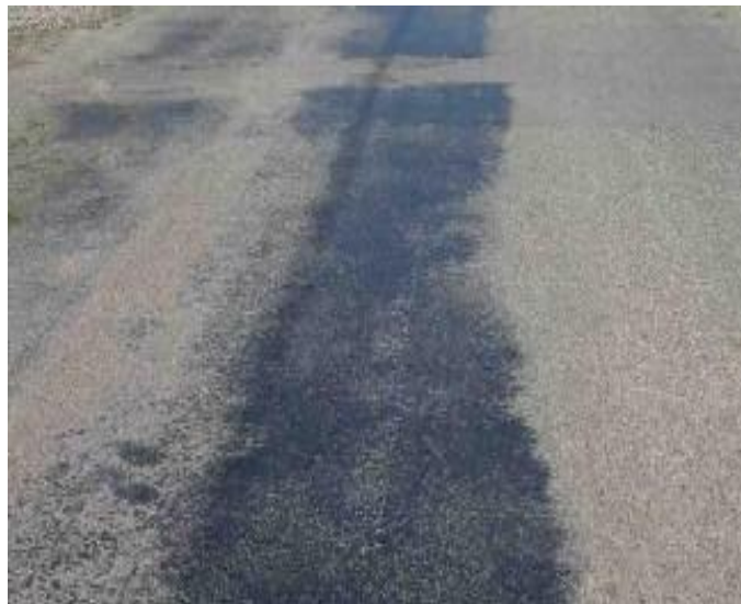
Figure I-7 : Ressuage de la chaussée.
