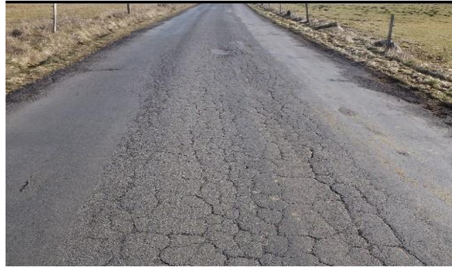
Figure I-3 : Faïençage de la chaussée.
