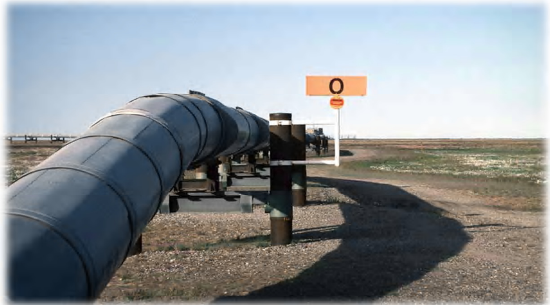
Fig I. 1 : un tube pour le transport par installations fixes du gaz
