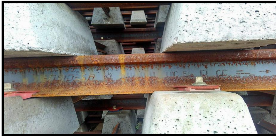
Figure 15 : Rails UIC 54 attachés sur travers
