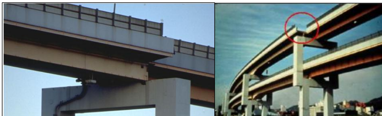
Figure I-2. Déplacement latéral du tablier et chute des appuis sur la palée d'un pilier - Kobe, 1995.
