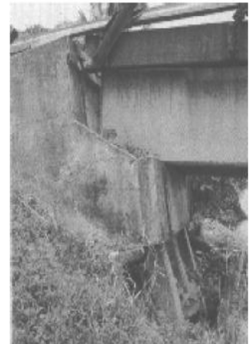
Figure I-9 Glissement de culées Costa Rica, 1990 [3]
