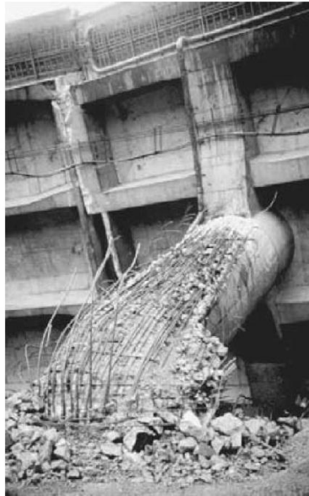
Figure I-6. Rupture en flexion du pont [5]
