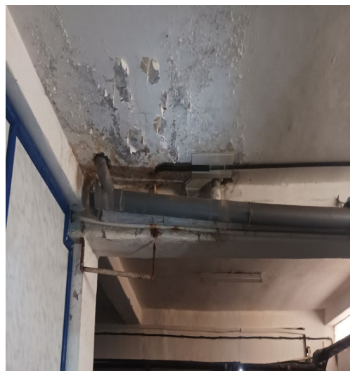
Figure 15: Décollement de la peinture dû aux infiltrations des eaux
