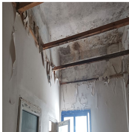
Figure 17: Mauvaise étanchéité induisant des infiltrations des eaux
