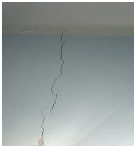
Figure 14: Fissures au niveau des murs de remplissage
