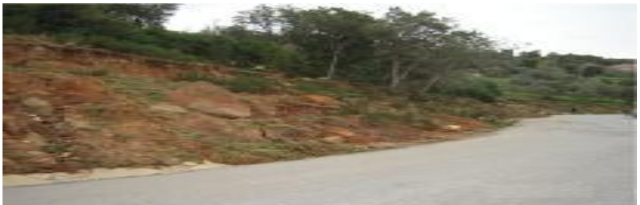
Photo sur l'endommagement et bouchées des fossés.
