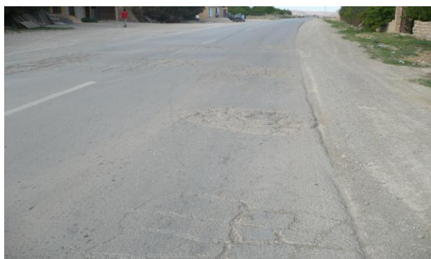
RN45 AU PK 48+600 Faïençages à mailles fines localisées.
