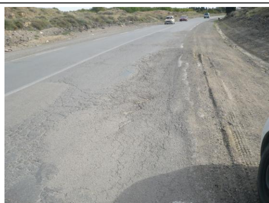
RN45 AU PK 55+000 Faïençages à mailles fines suivi par léger affaissement localisées.
