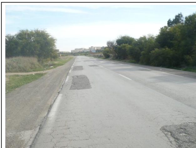
RN45 AU PK 55+800 Faïençages à mailles fines et réparation localisées.
