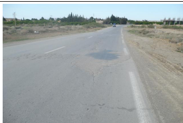
RN46 AU PK 52+200 Faïençages à mailles fines suivi par léger affaissement localisées.
