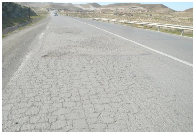
RN45 AU PK 46+900 Faïençages à mailles fines localisées.
