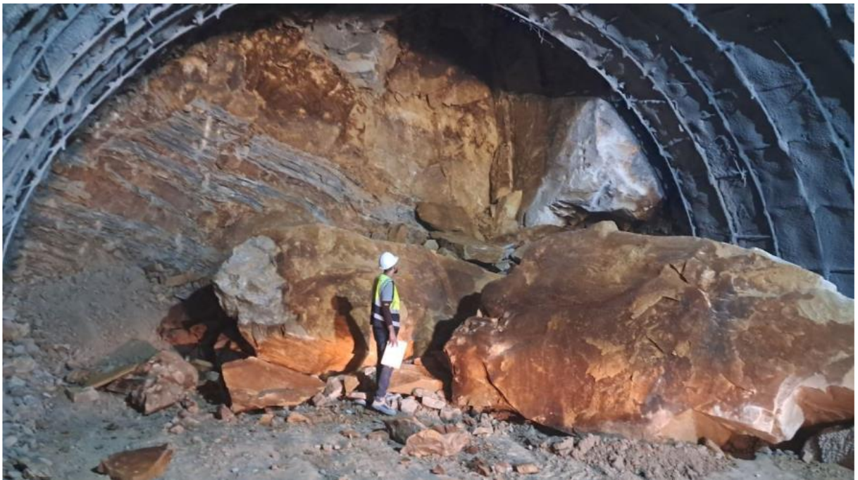
Figure I.16 Éboulement de blocs rocheux au front de taille d'un tunnel dans un massif de flysch. (Pris du tunnel T2).
