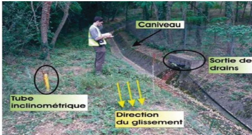
Figure IV.5 drainage des eaux de surface à l'aide d'un caniveau (Alpes-Maritimes) (S11).
