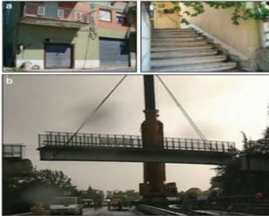
Figure IX .3. Bâtiment gravement endommagé (a); retrait d'un passage supérieur pour piétons de l'autoroute (b)
