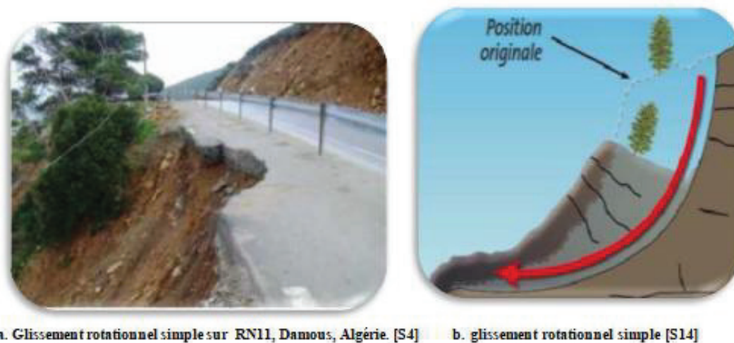
Figure I.12 Exemple d'un glissement rotationnel simple
