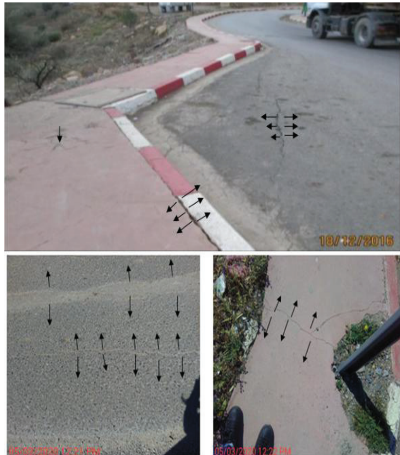
Figure VI .8. Fissuration de la chaussée et affaissement de l'accotement.
