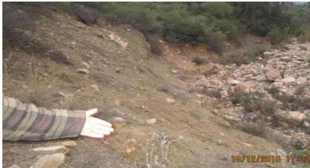
Figure VI.14. Affouillement du talus aval du versant sous l'effet des crues de l'oued
