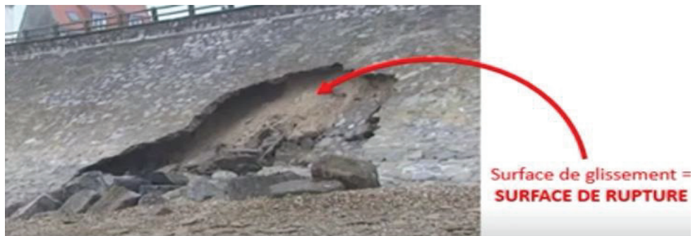
Figure II.3 Exemple de rupture (défaut de stabilité de pente) [S18].
