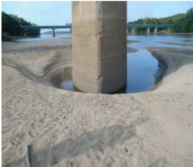
Figure I. 9. Affouillement autour d'une pile.
