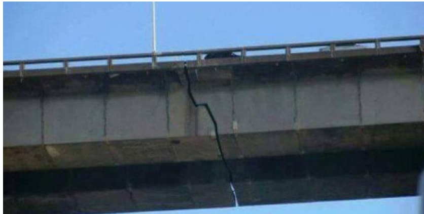
Figure XII.2 : Fissure dans le pont Champlain
