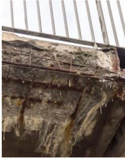
Figure XII.1 : Corrosion dans un pont
