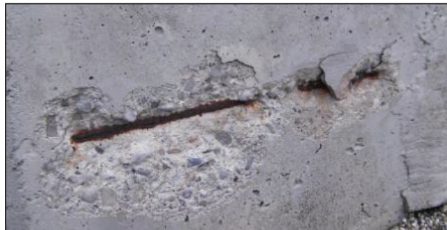
Figure I.11 Carbonatation du béton
