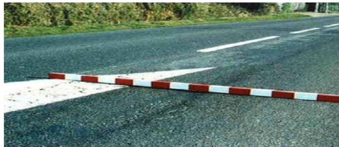
Figure 10: Exemple d'un affaissement hors rive
