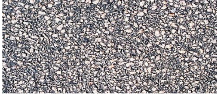
Figure 19: Exemple de désenrobage de l'enrobé bitumineux
