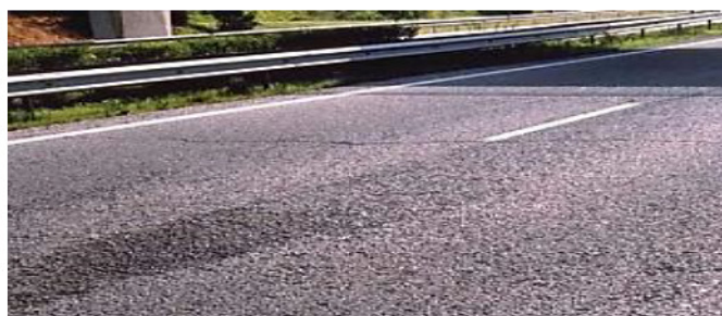
Figure 32: Arrachement (de granulats) causé par du désenrobage
