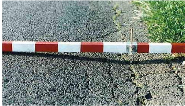
Figure 9: Exemple d'un affaissement de rive
