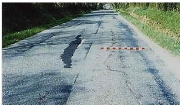
Figure 14: Exemple de fissuration d'adaptation
