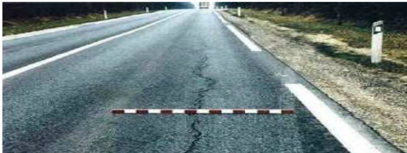
Figure 12: Exemple de fissuration longitudinale en bande de roulement
