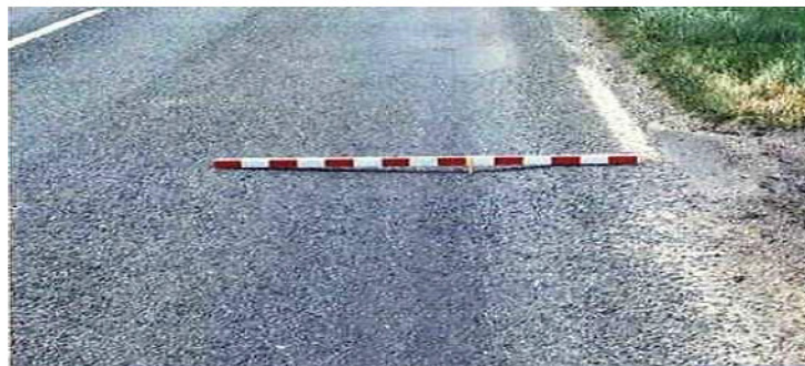
Figure 8: Orniéage de chaussée
