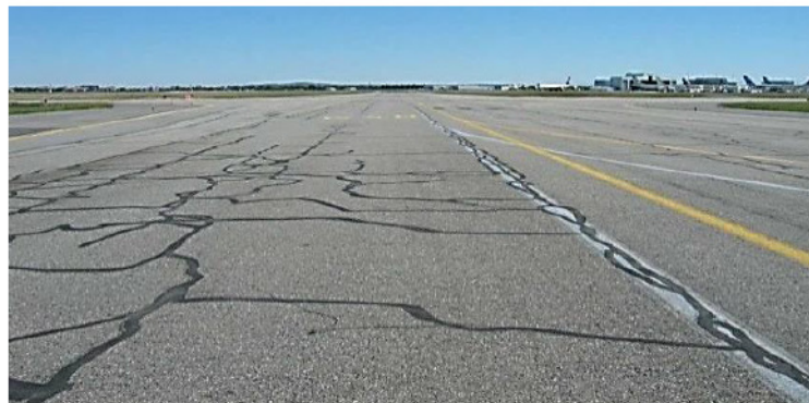
Figure 18: Exemple de fissuration anarchique
