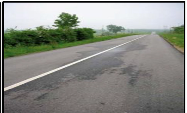
Figure 23: Résurgence d'eau au joint de chaussée
