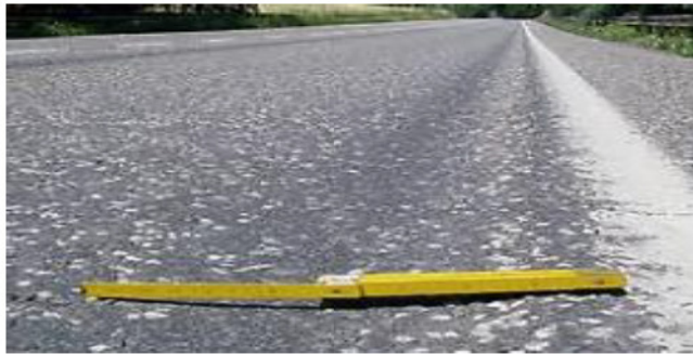
Figure 29: Orniérage d'un enrobé bitumineux
