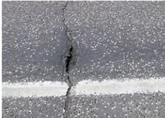
Figure 31: Fissure de fatigue dans un enrobé bitumineux
