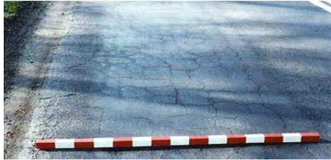
Figure 15: Exemple de faïençage dans les bandes de roulement
