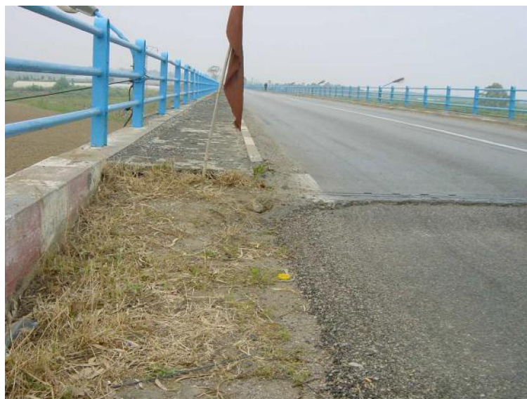
Figure 1. 27 : Tassement derrière la culée d'un pont à Boumerdes, "Algérie 2003".
