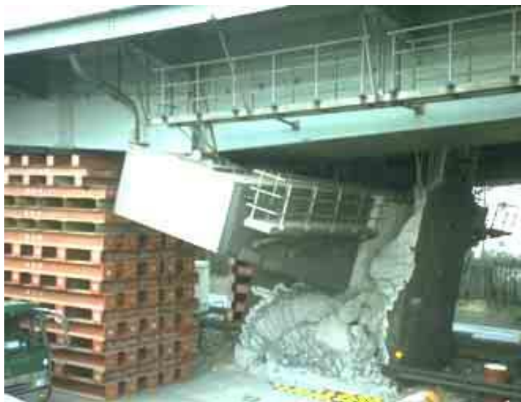
Figure 1. 20 : Ruine à l'effort tranchant d'une pile de pont en béton armé lors du séisme de Kobe en 1995.
