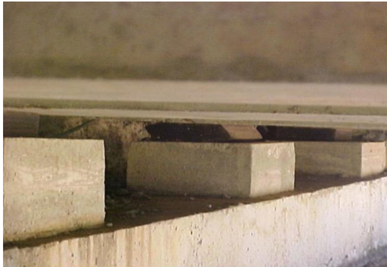
Figure 1. 23 : Distorsion des appareils d'appui, due aux effets du séisme du 21 mai 2003 - Pont sur Oued Sebaou (Kibboua, 2012).
