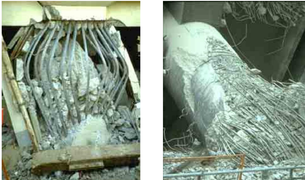
Figure 1. 16 : Ruine de piles de ponts en béton armé lors du séisme de Kobe en 1995.
