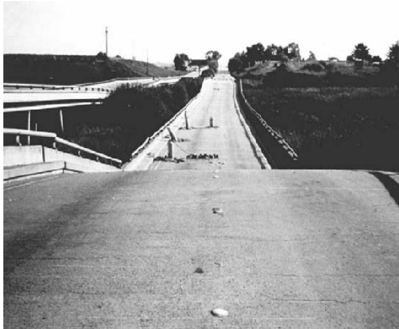
Figure 1. 8 : Effondrement du pont Struve Slough par poinçonnement du tablier sous l'effet de la composante verticale lors du séisme de Loma Prieta (USA, 1995).
