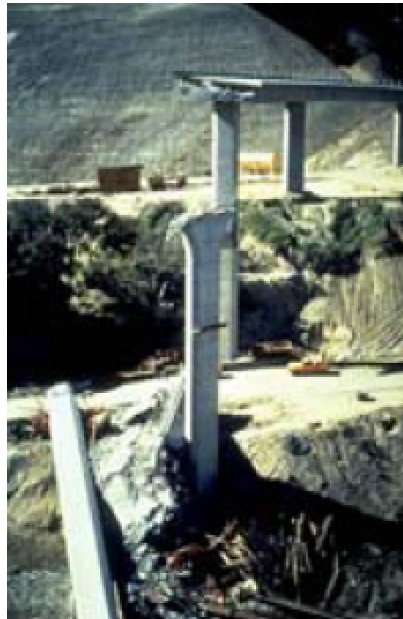
Figure 1.12 : Echappement d'appui dû à une courbure importante lors du séisme de San Fernando (USA, 1971).
