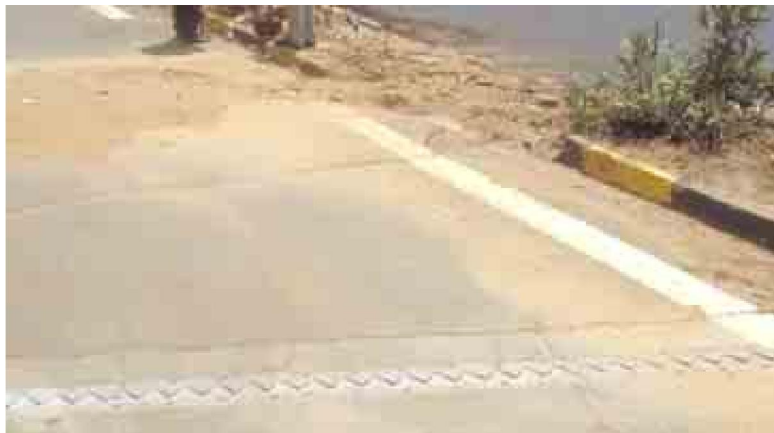
Figure 1. 26 : Tassements faibles derrière la culée d'un pont-route suite au séisme de Boumerdes, Algérie en 2003.
