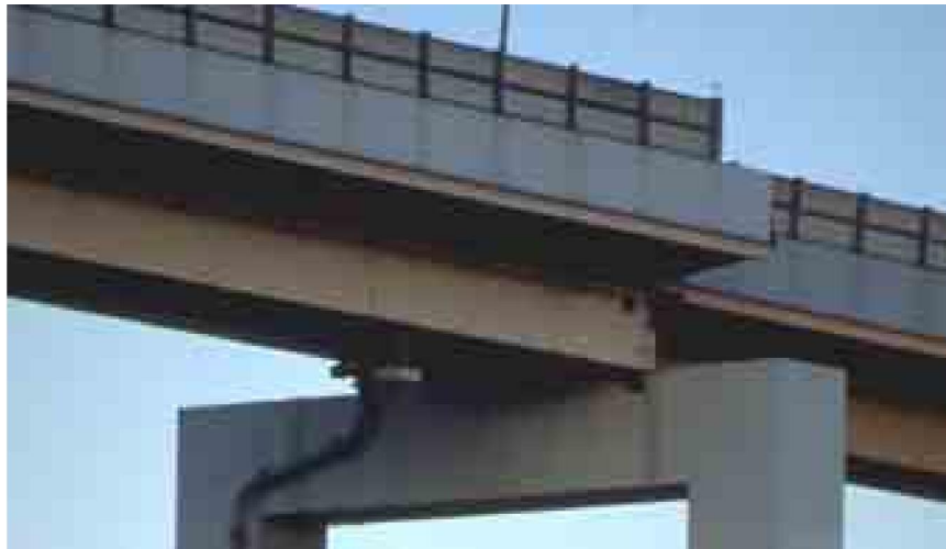
Figure 1. 6 : Déplacement latéral du tablier d'un pont lors du séisme de Kobe en 1995.
