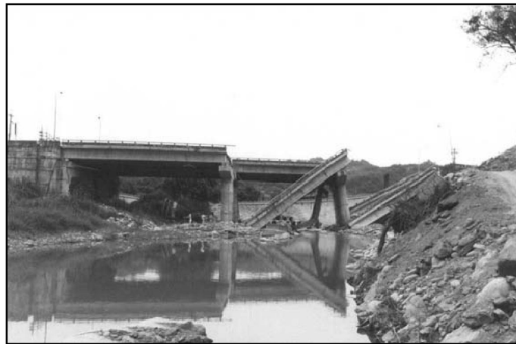
Figure 1. 4 : L'effondrement du pont Tsu Wei dû au glissement de terrain durant le séisme de Ji Ji, Taiwan.
