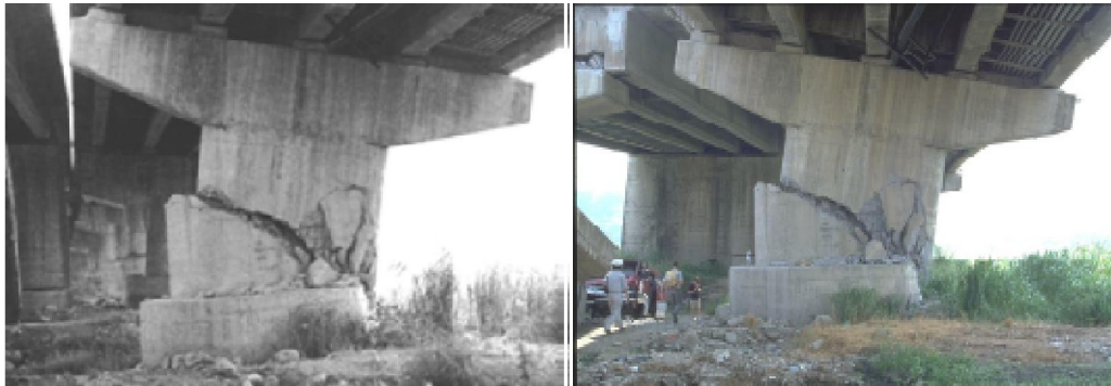
Figure 1. 18 : Rupture des piles par cisaillement ou effort tranchant lors du séisme de Chi-Chi.
