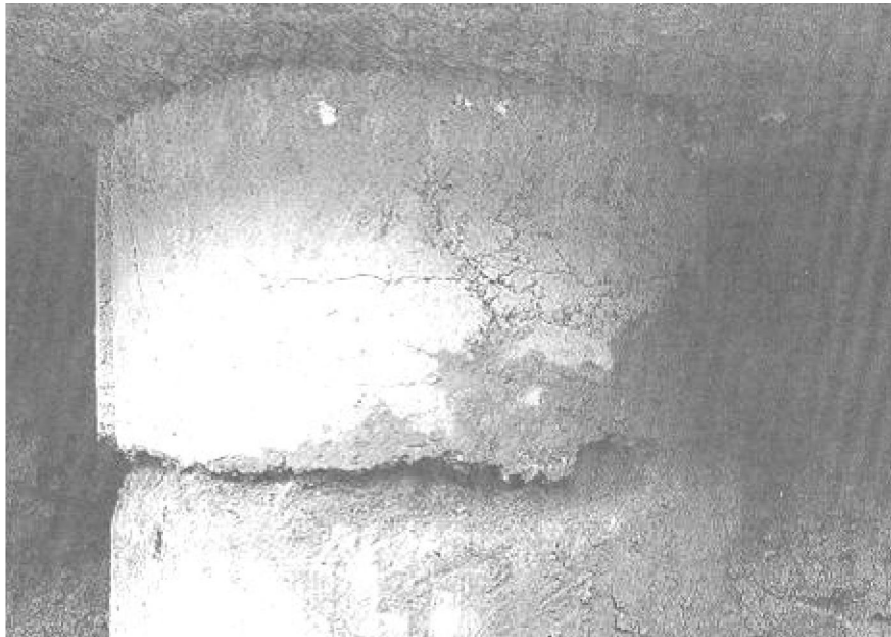
Figure 1. 30 : Dommage observé sur une tête de pieux.
