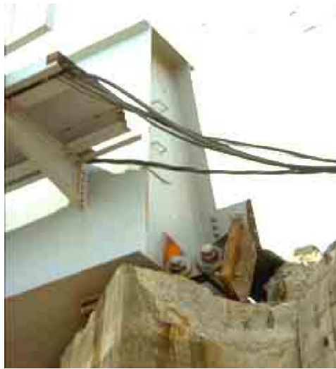
Figure 1.21 : Appui longitudinal arraché sur la culée d'un pont poutre, Kobe 1995.
