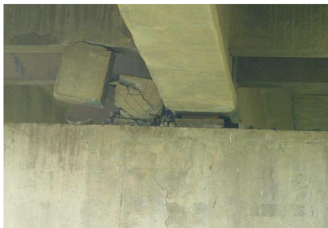
Figure 1.22 : Appui longitudinal écrasé, sur la culée d'un pont-poutre, Boumerdes 2003.
