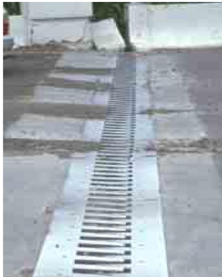
Figure 1. 25 : Joints de chaussées endommagées suite au séisme de Taiwan en 1999.
