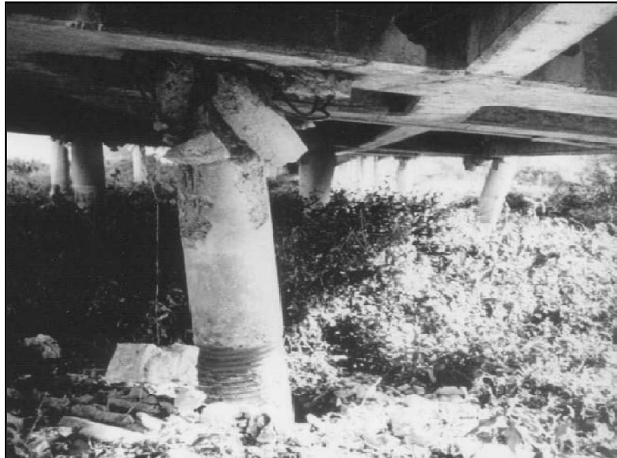
Figure 1. 29 :Endommagement des pieux sous un pont.
