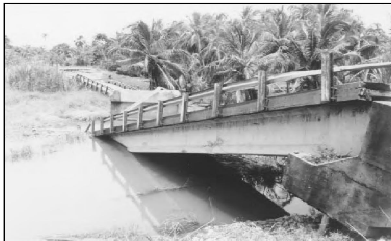
Figure 1. 3 : L'effondrement du Pont de Rio Bananito en 1991 séisme de Costa Rica
