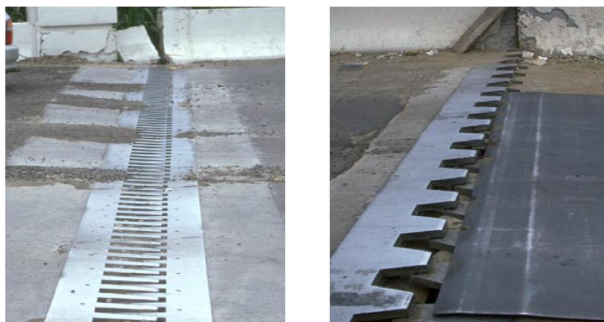
Figure 1. 24 : Joints de chaussées endommagés "Taiwan 1999".
