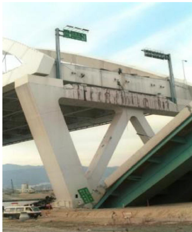
Figure 1. 9 : Effondrement du tablier dû à la liquéfaction du sol.
