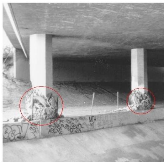
Figure 1. 19 : Rotules plastiques dans les piles d'un pont suite au séisme de Northridge, 1994.
