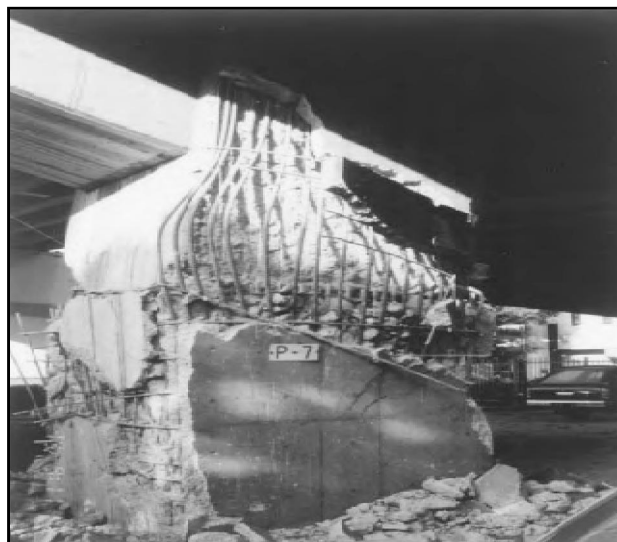
Figure 1.13 : Rupture d'une pile de pont à mi-hauteur durant le séisme de Hyogo-Ken en 1995.
