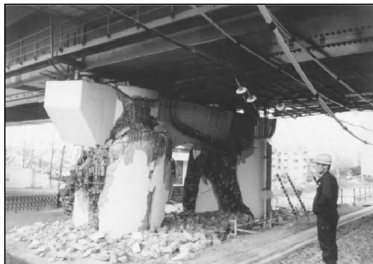
Figure 1. 15 : Rupture de la pile Interstate 10, La Cienega-Venice Undercrossing en 1994 séisme de Northridge.
