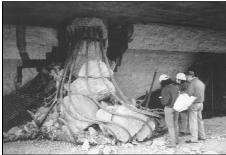
Figure 1. 14 : Rupture de la pile Interstate 10, La Cienega-Venice Undercrossing en 1994 séisme de Northridge.
