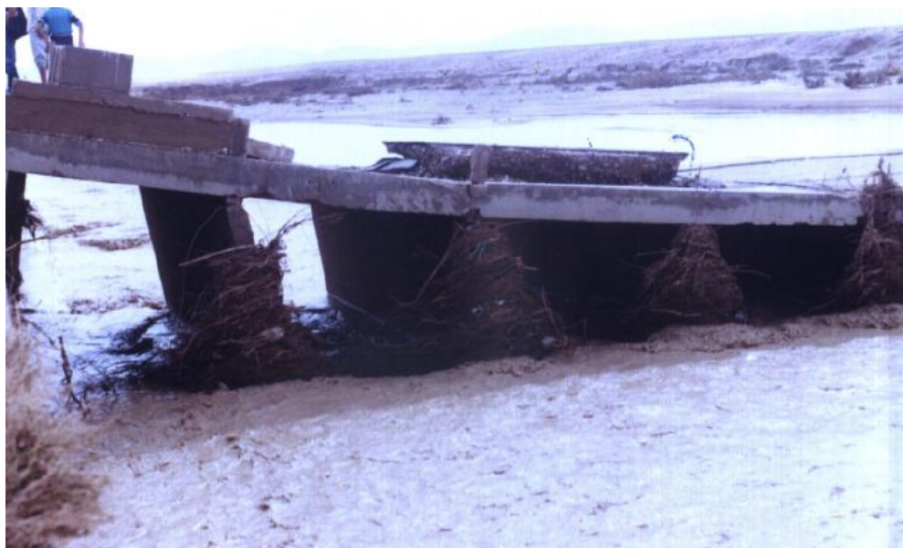
Figure I. 10: L'effondrement du pont enjambant Oued Barika
