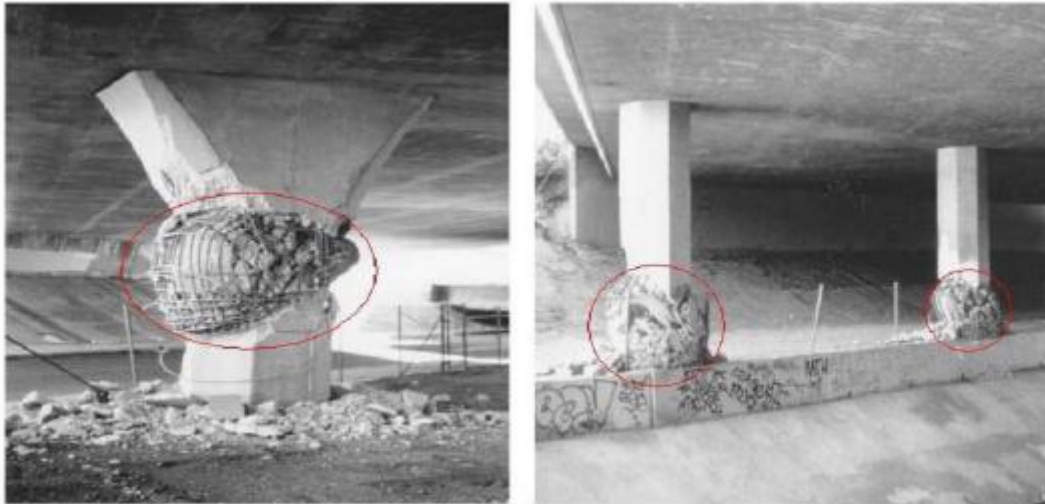
Figure. 4.8. Rotules plastiques des piles des ponts
