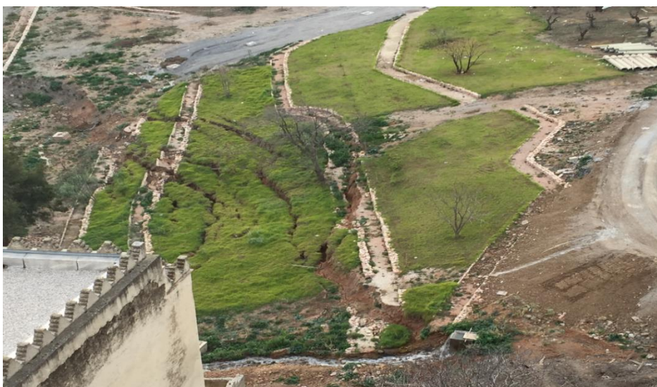
Figure III.2. Déclenchement de glissement (2016)
