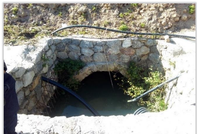
Figure III.9. Canal d'eau à haut débit.
