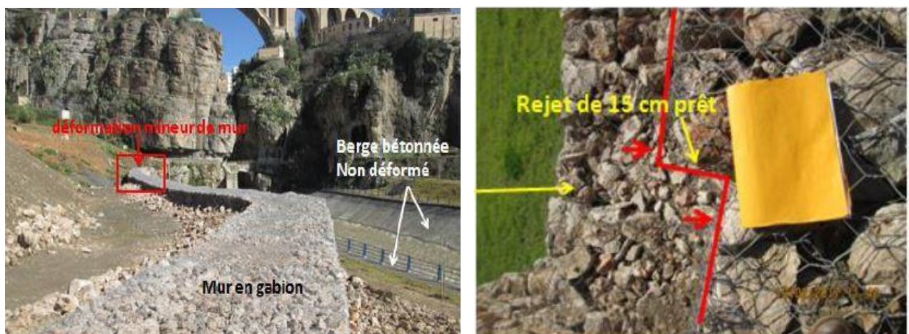
Figure III.11. Déformation de mur en gabion
