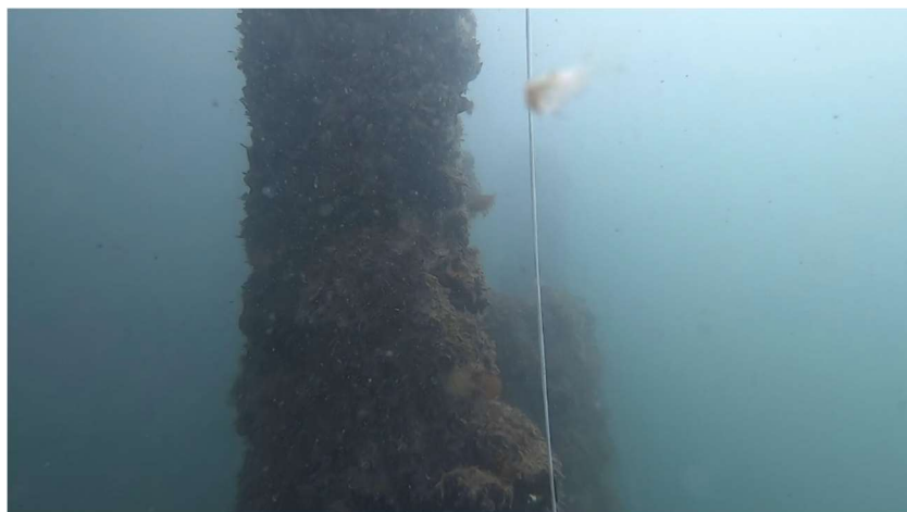
Figure 35.Pieu en béton armé enrobé par les biofilms marin.
