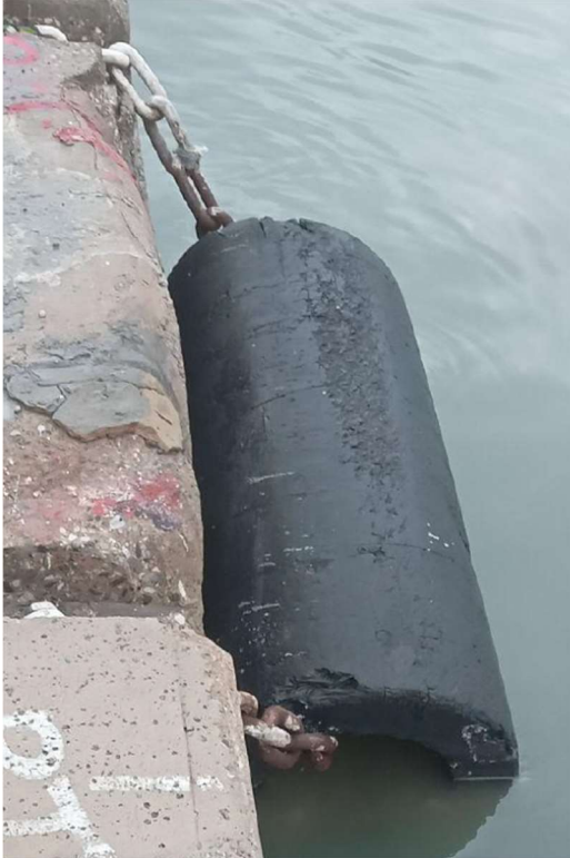
Figure 31.État des défenses d'accostage.
