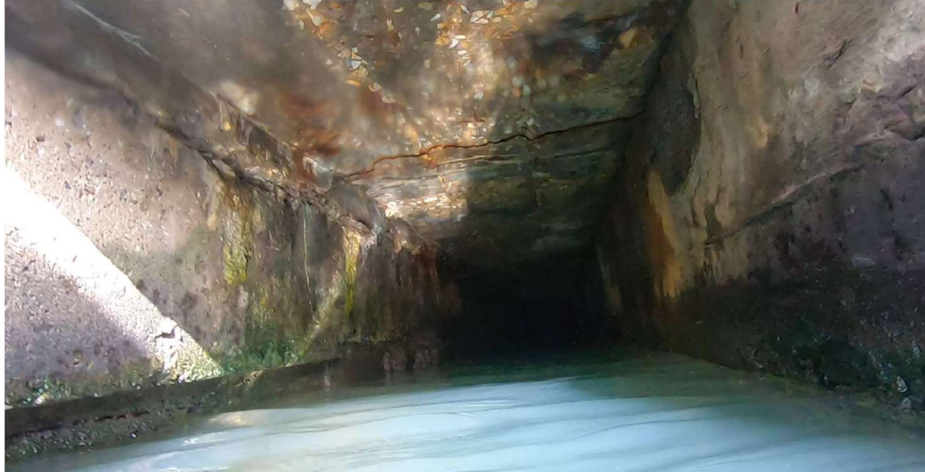
Figure 36. Dégradation du béton.
