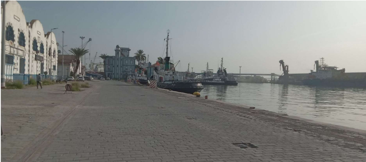
Figure 29.État du terre-plein.
