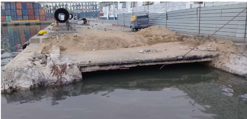
Figure 33.Coupe sur la dalle montrant la perte de l'enrobage et la disparition des armatures.
