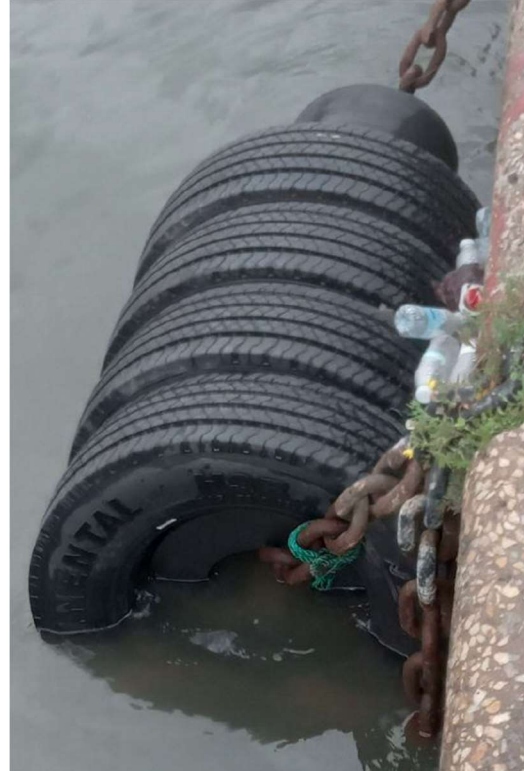
Figure 32.État des défenses d'accostage.
