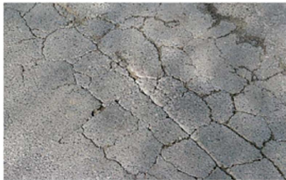
Figure II-2: Dégradations prématurés au niveau des giratoires
