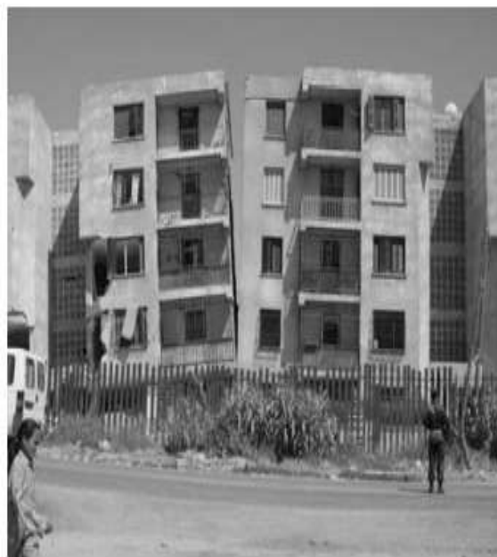
Fig.1.3 Ouverture entre deux bâtiments (Boumerdes, 2003) [4].
