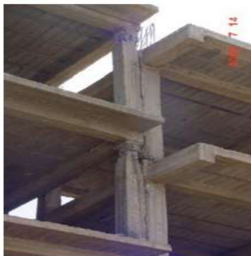
Fig.1.2 Dommages des poteaux dus à l'entrechoquement (le séisme de Boumerdes 21 May 2003) [3].
