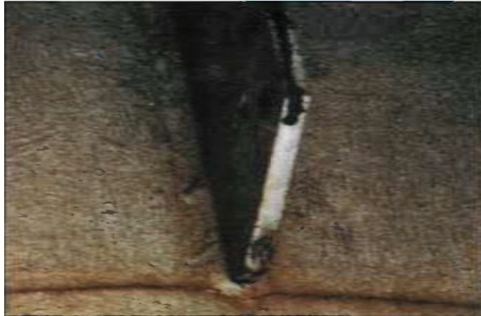
Figure.VII.17 Fissure de fatigue à la base d'un raidisseur vertical
