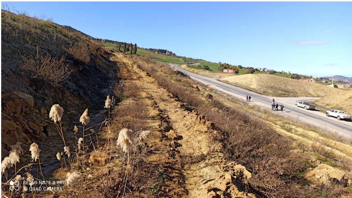
Figure 5 : Talus de déblai caractérisé par l'état d'argile décomprimée.
