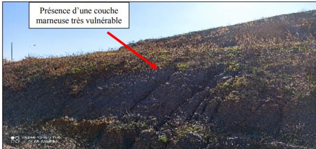
Figure 6 : Talus de déblai caractérisé par des fissures ouvertes.
