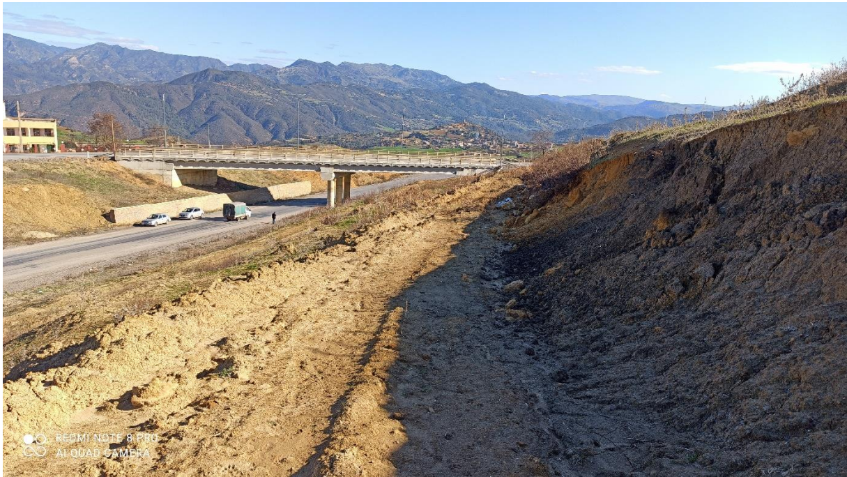
Figure 4 : Talus de déblai caractérisé par des érosions intenses.
