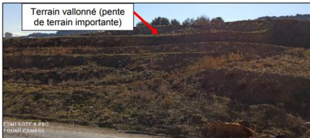
Figure 7 : Vue générale de l'escarpement du glissement
