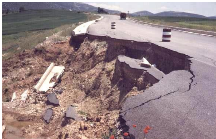
Figure 1.13 : Rupture d'un remblai routier dû à la propagation latérale -Séisme de Kozani en 1995 (Grèce)/(Syner-G D3.7, 2009).
