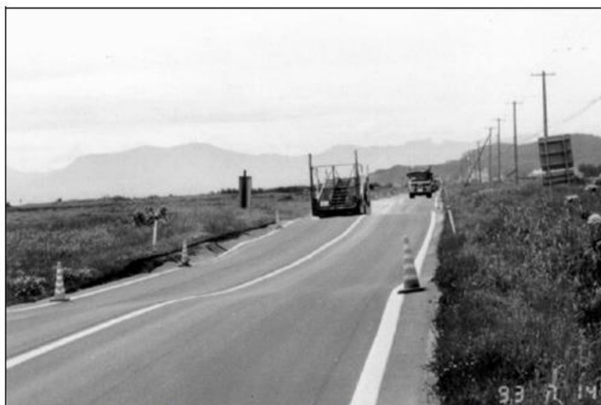
Figure 1.7 : Ondulation de la chaussée par les tassements différentiels - Séisme de Hokkaido-Nansei-Oki en 1993 (Japon)/ (FHWA, 2004).
