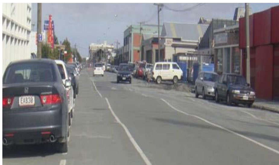
Figure 1.8 : Ondulation de la chaussée par les tassements différentiels - Séisme de Chrischurch en 2011 (N. Zélande)/(Chouw et al., 2011).
