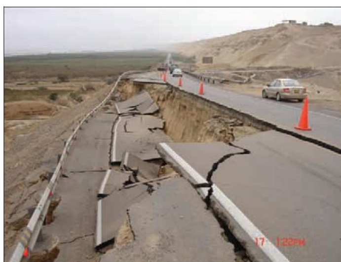
Figure 1.14 : Rupture de remblai et de chaussée due à la propagation latérale – Séisme de Le Pesco (Pérou-2007)/(O'Connor et al., 2007).
