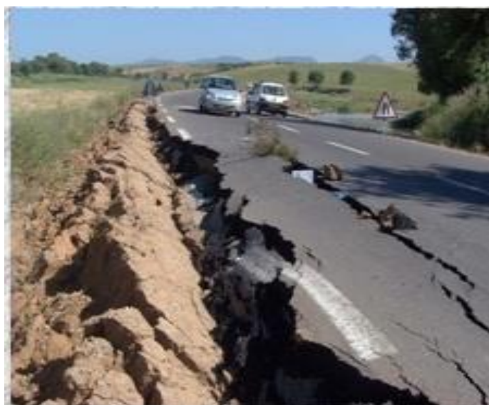
Figure 1.12 : Rupture d'un remblai routier dû au tassement provoqué par la densification du remblai - Séisme de Boumerdes en 2003 (Algérie)/(CTTP, 2003).
