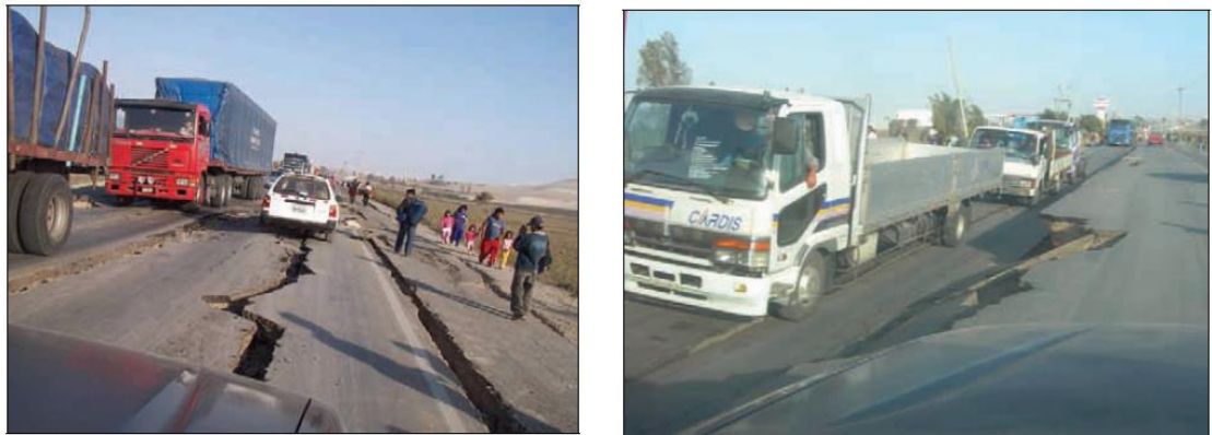
Figure 3.10 : Endommagement d'une chaussée à plusieurs voies Pan Américain Highway (Perou) (O'Connor et al., 2007).
