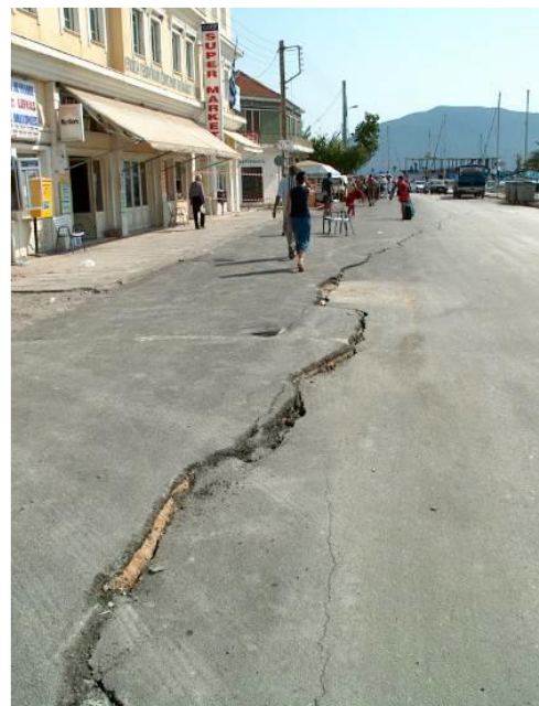
Figure 1.6 : Endommagement de la chaussée dû à la liquéfaction-Séisme de Lefkas en 2003 (Grèce)/ (BRGM, 2006).
