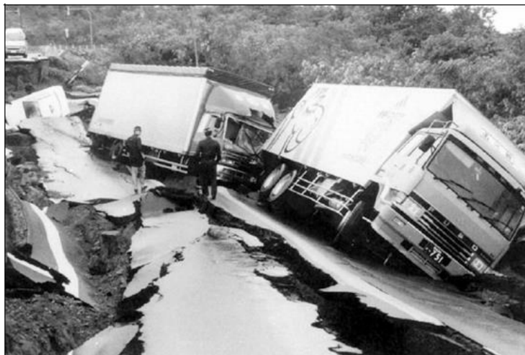
Figure 1.11 : Rupture d'un remblai autoroutier dû au tassement et à la déformation du sol meuble /séisme de Hokkaido-Nansei-Oki en 1993 (Japon)/(FHWA, 2004).
