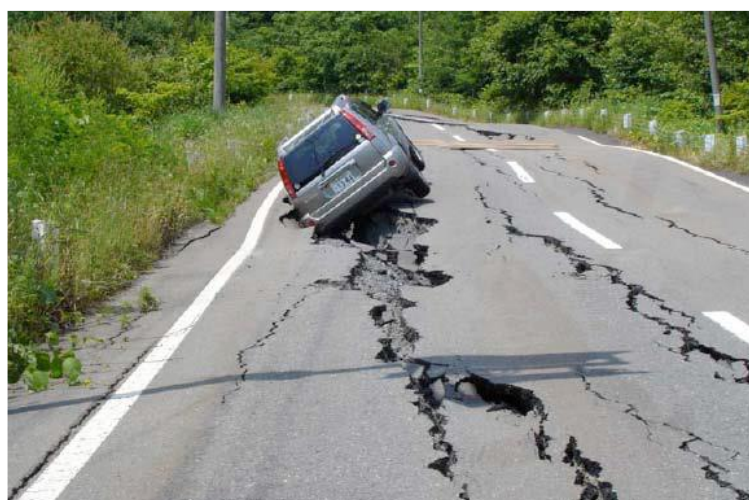
Figure 1.15 : Endommagement d'un remblai routier dû à un glissement latéral - Séisme de Iwate Miyagi-Nairiku en 2008 (Japon) /(Syner-G D3.7, 2009).
