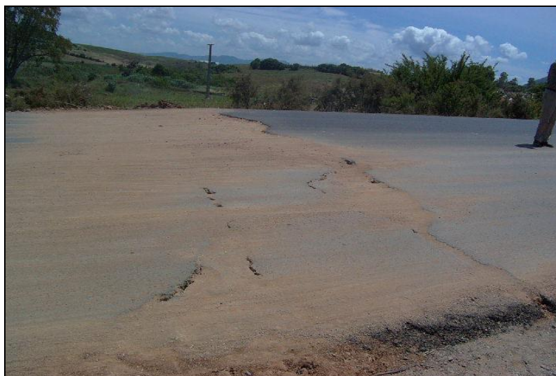
Figure 1.9 : Chaussée endommagée par les tassements différentiels dus à la densification du sol support - Séisme de Boumerdes en 2003 (Algérie)/(CTTP, 2003).
