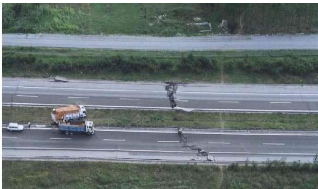
Figure 1.3 : Dommages sur autoroute dus à la rupture de faille en surface-Séisme de Kocaeli en 1999 (Turquie)/ (BRGM, 2006).
