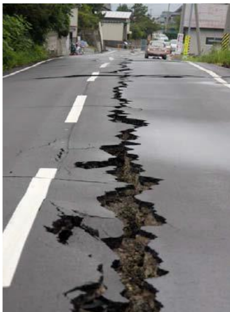
Figure 1.5 : Endommagement de la chaussée due à la propagation latérale -Séisme de Niigata-Chuetsu Oki en 2007 (Japon) /(Syner-G D3.7, 2009).
