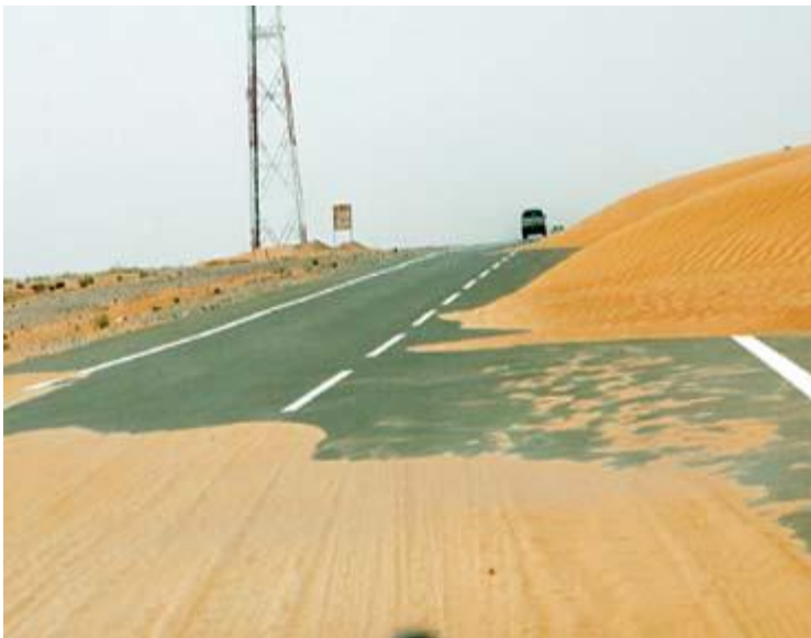
Figure(23) : Photo présente le problème de l'ensablement
