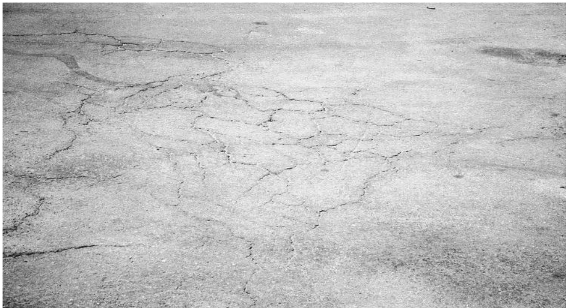
Figure 1.9 Exemple de chaussée atteinte la fissuration par fatigue du béton bitumineux
