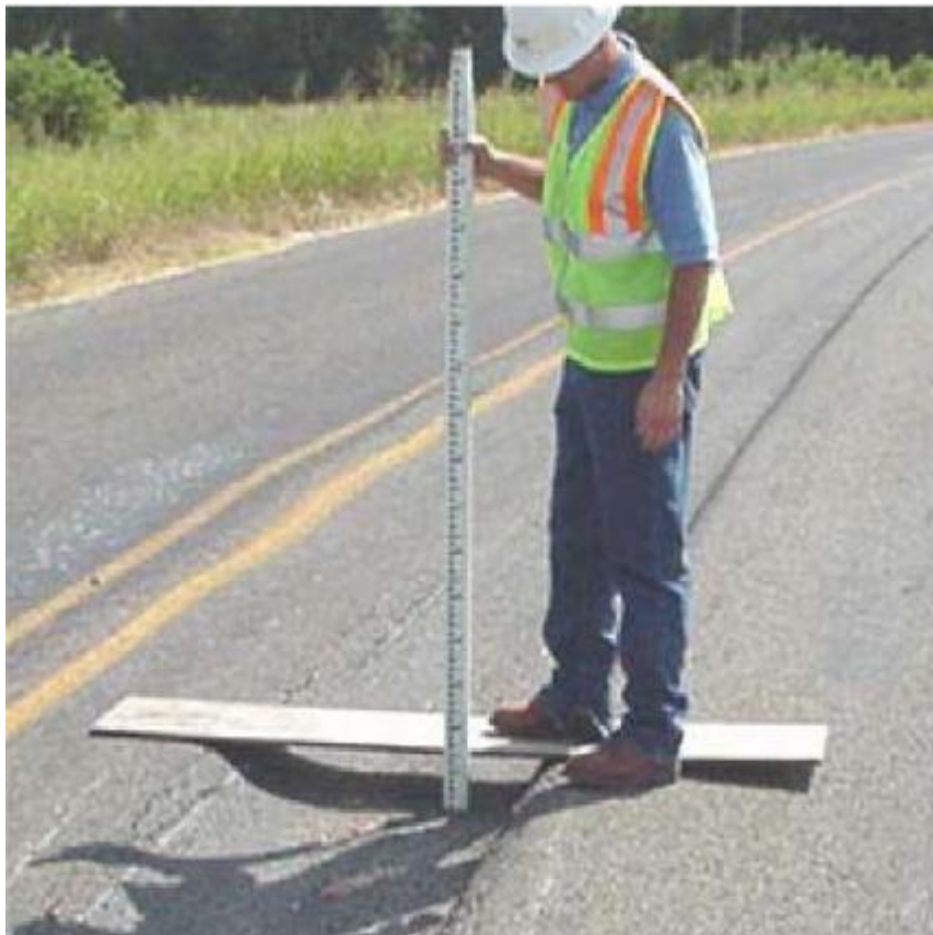
Figure 1.7 Exemple de chaussée atteinte d'orniérage
