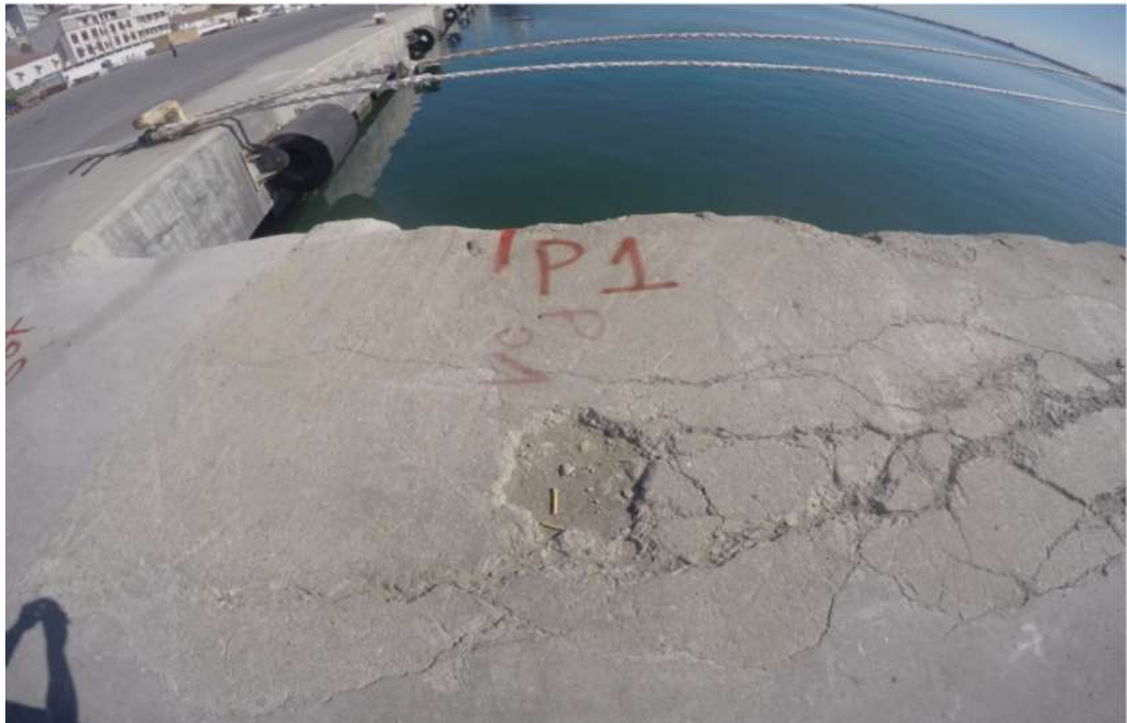
Figure IV.1 : Fissuration, scarification et tassement du béton
