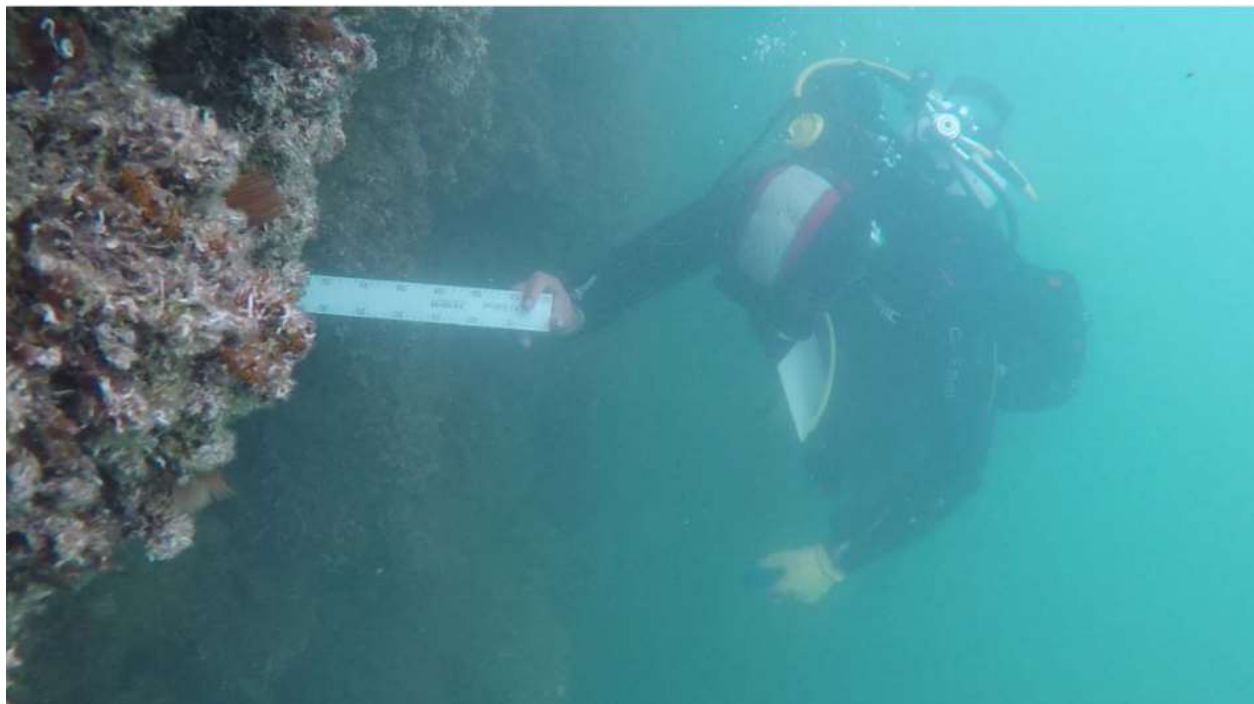
Figure IV.2 : Présence d'une cavité
