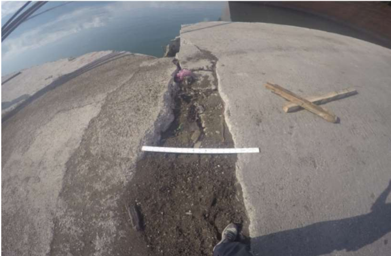
Figure IV.3 : Fissure profonde d'un élément en béton
