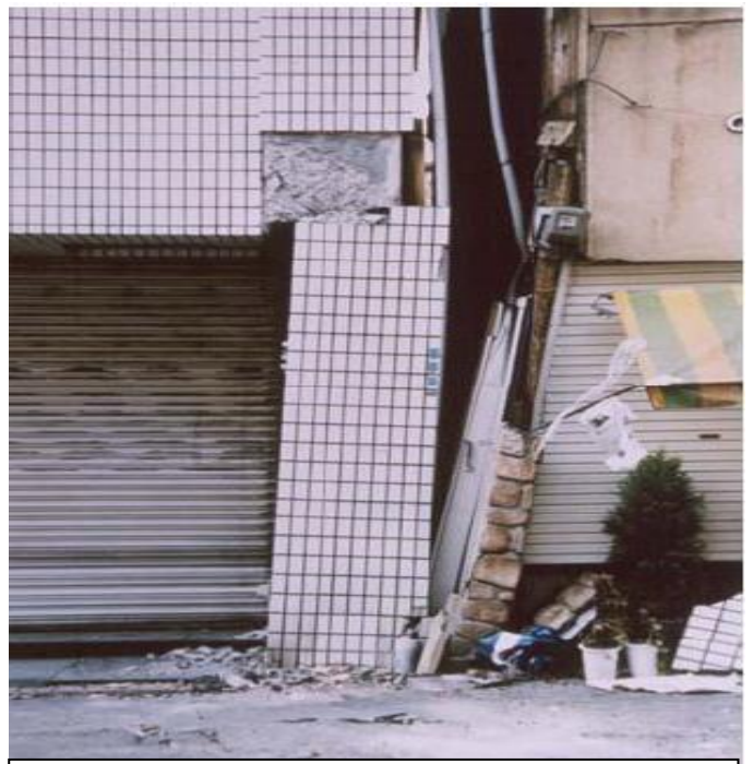
Figure 1.7 : Séisme de Kobé 1995.
