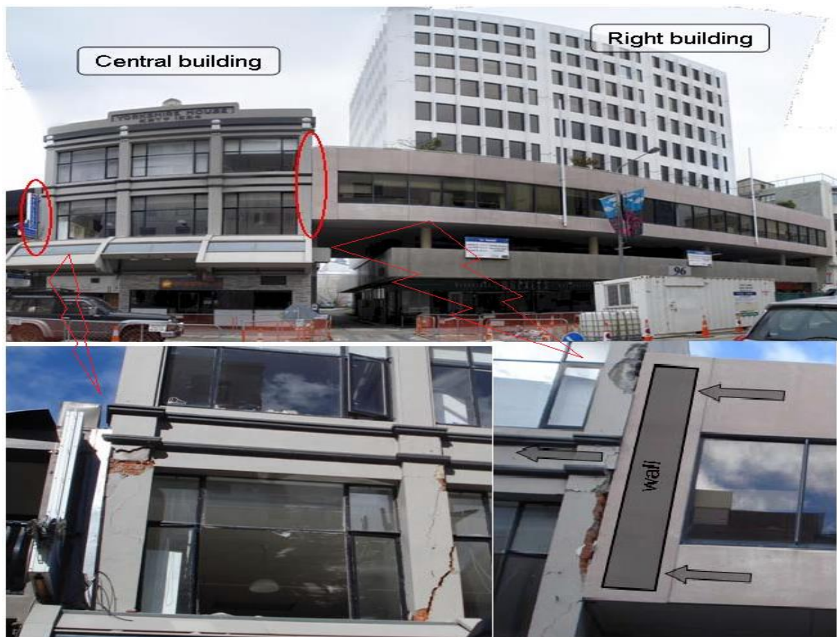
Figure 1.14 : Collision de deux bâtiments de hauteurs considérablement différentes. Haut: image avant le séisme (bâtiment de gauche est principalement à l'extérieur du champ de vision). En bas: les détails des dommages après le séisme de Christchurch 2011.
