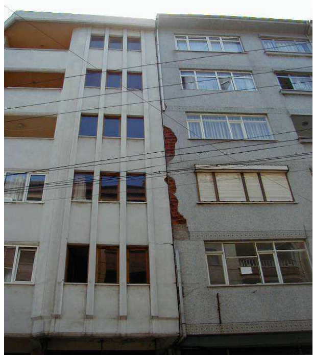
Figure 1.9 : Séisme de Kocaeli 1999.
