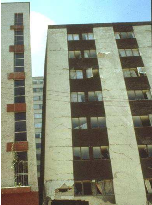
Figure 1.8 : Séisme de Mexico 1985.
