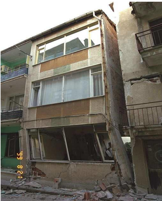
Figure 1.6 : Séisme d'Izmit, Turquie 1999.
