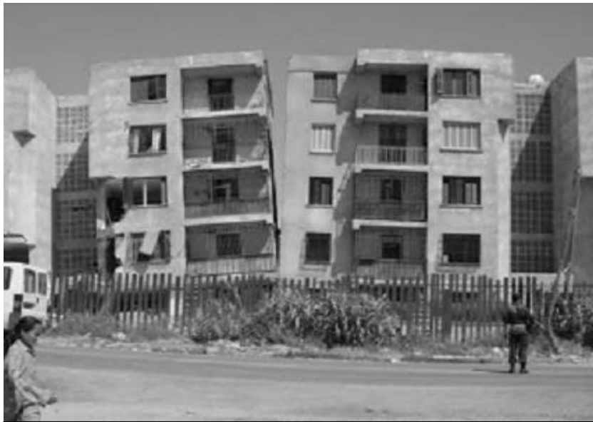
Figure 1.19 : Ouverture entre deux bâtiments (Boumerdes, 2003).
